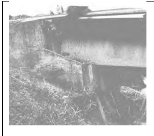
Figure I.9 : glissement d'une culée du pont à Costa Rica 1990 [7]
