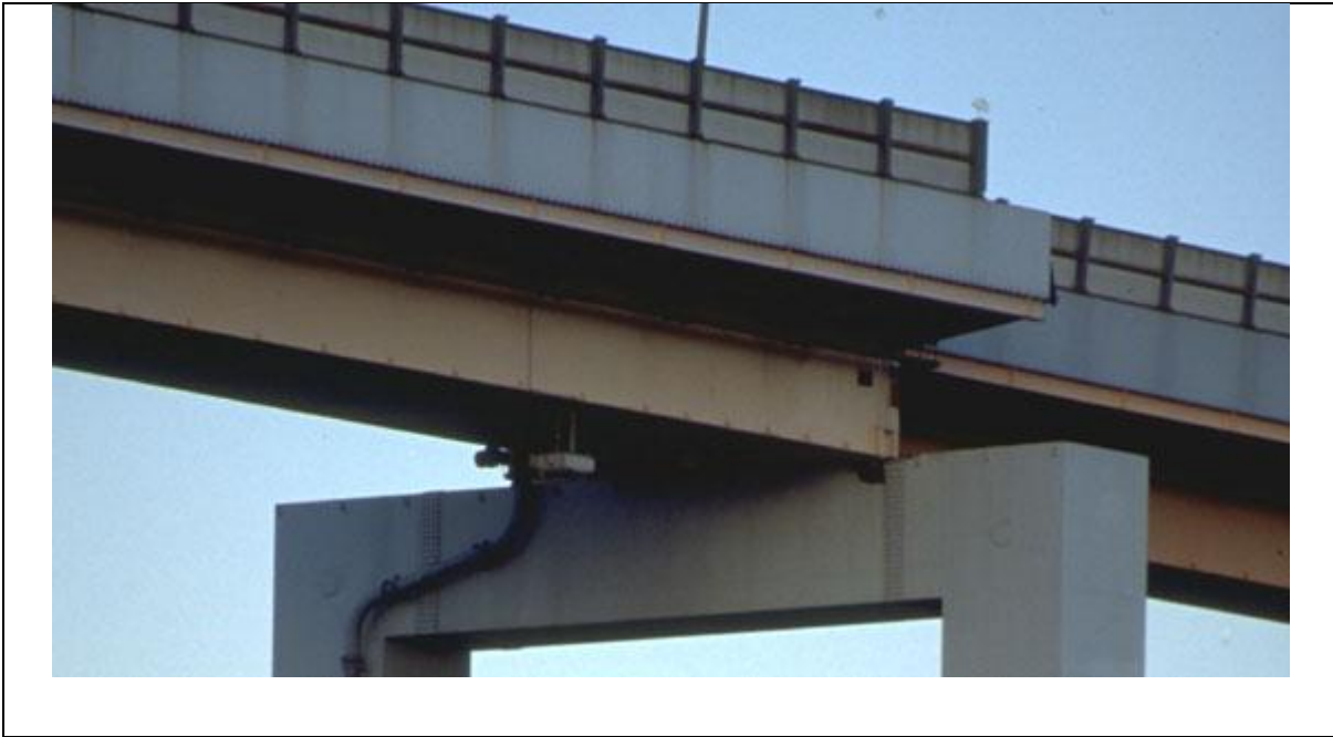
Figure I.5 : déplacement latéral du tablier et chute des appuis sur la palée d'un pilier à Kobe 1995 [3]
