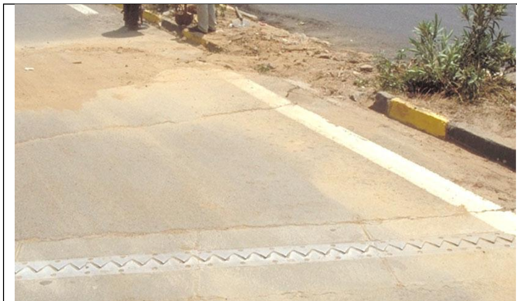
Figure I.10 : Tassements faibles derrière la culée d'un pont-route à Boumerdès, Algérie, 2003 [9]
