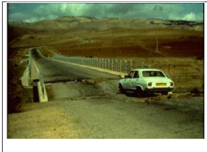
Figure I.6 : déplacement transversal du tablier et destruction des butées lors du séisme El Asnam 1980 [2]
