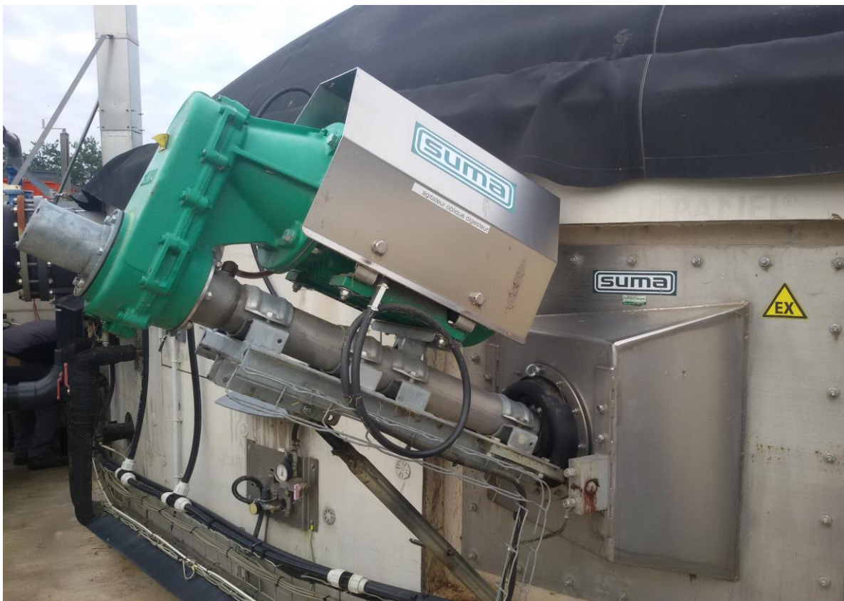
Figure 22: Agitateur du digesteur de la ferme expérimentale –La Bouzule–
