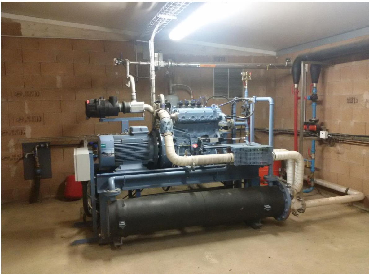
Figure 24 : Chambre de cogénération de la ferme expérimentale –La Bouzule-
