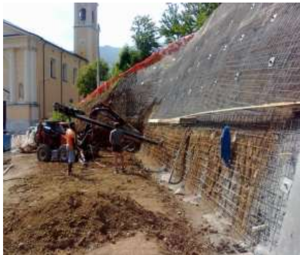
Figure 3.4 : Mise en place des boulons d'ancrages dans le sol. (D'après les Recommandations Clouterre 91).
