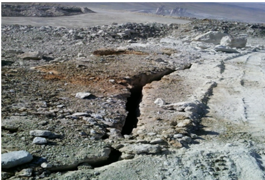
FIGURE V.7 – Fissuration engendré par le tir
