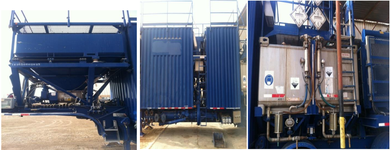
Figure 5 : Bac de stockage de polymère, Réservoirs d'hydratation, réservoirs d'additifs (stage Schlumberger, 2015)
