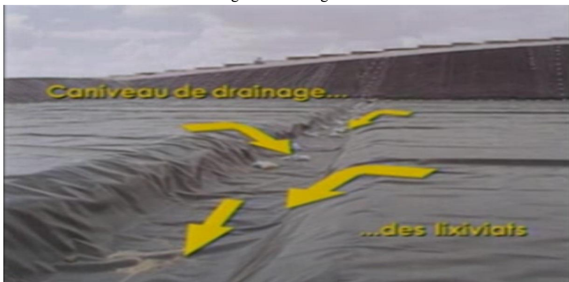
Figure II.4.5.1.2 : Caniveau de drainage des lixiviats
