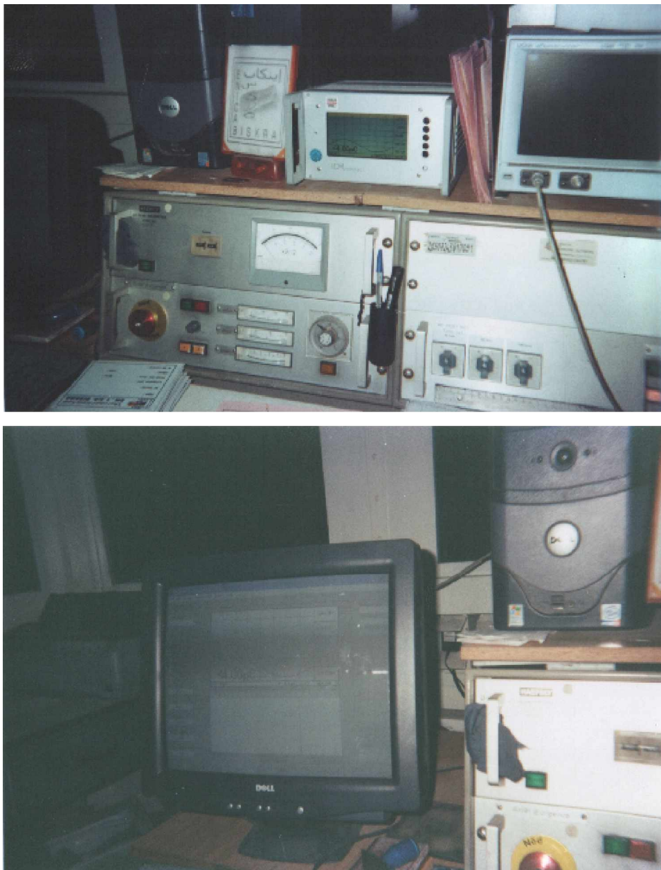
Figure IV.6 : Vue d'ensemble des équipements de mesure de D.P
