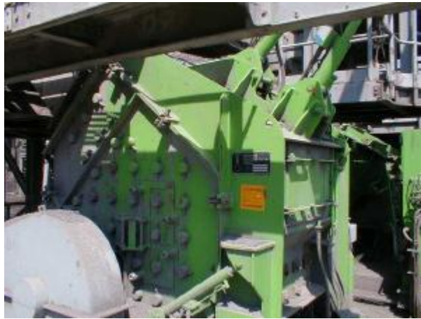
Fig. IV.2 : Concasseur à percussion (KRUPP HAZMAG)
