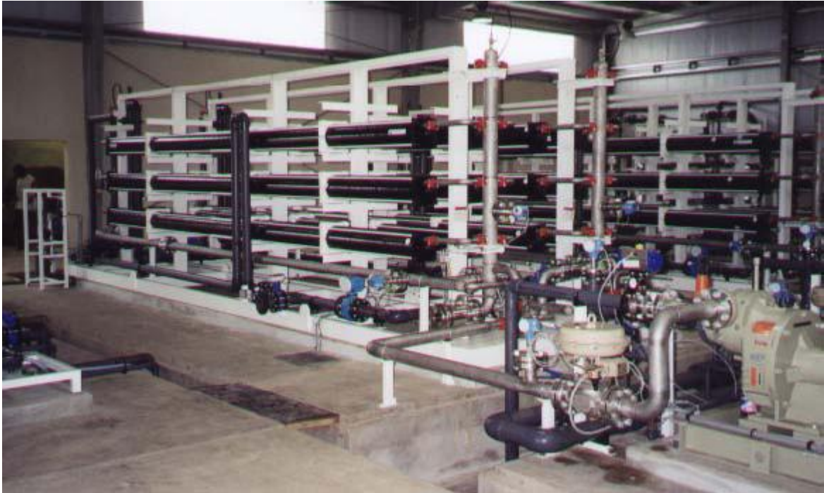
Figure II-1 : Unité de dessalement par osmose inverse
