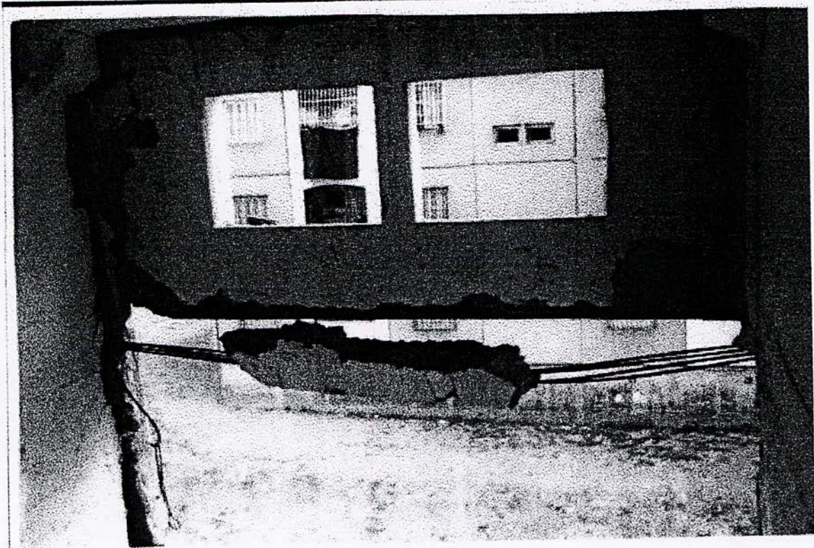
Foto2 : Dislocation de béton du joint horizontal.
