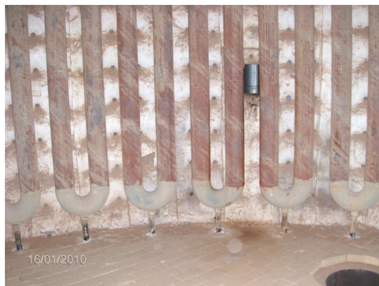
Figure 16: faisceaux tubulaires en zone de radiation
