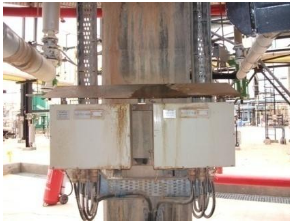
Figure 12: Les équipements de régulation détériorés par la condensation
