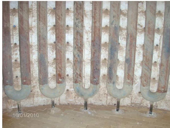
Figure 34: Le calorifuge de la zone de radiation
