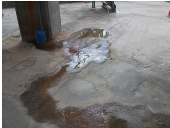
Figure 13: Débordement de l'eau sur le sol
