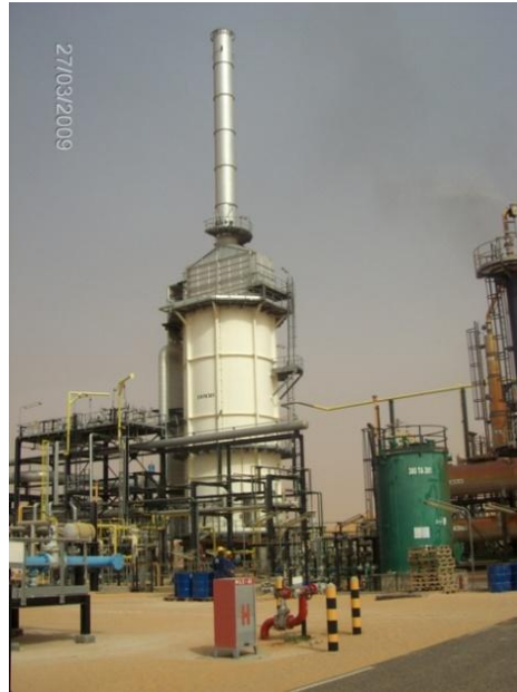
Figure 10: Le four de rebouillage du Train 3
