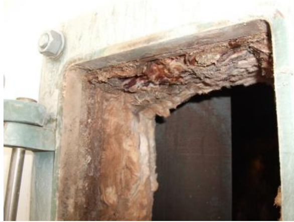
Figure 11: Ruissèlement du condensat entre la paroi et le calorifuge
