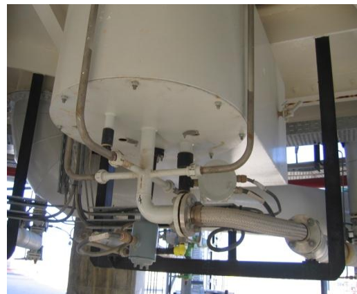
Figure 20: vue extérieur d'un brûleur
