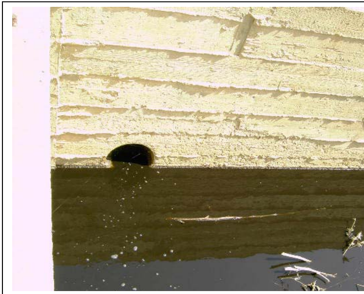
Canal de réception de lixiviats
