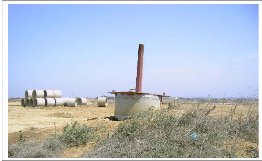
Figure V-11 : Système de récupération de BIOGAZ sans traitement
