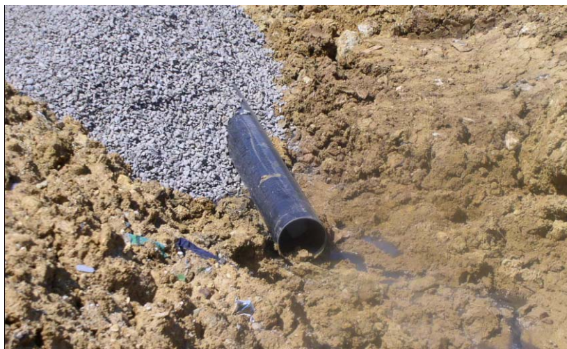
Figure V- 7 : conduite de drainage des lixiviats.
