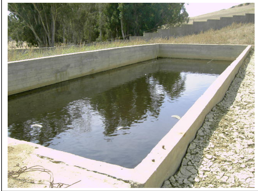
Figure V-17 : Bassin décantation de lixiviats au niveau du CET de Ouled Fayet
