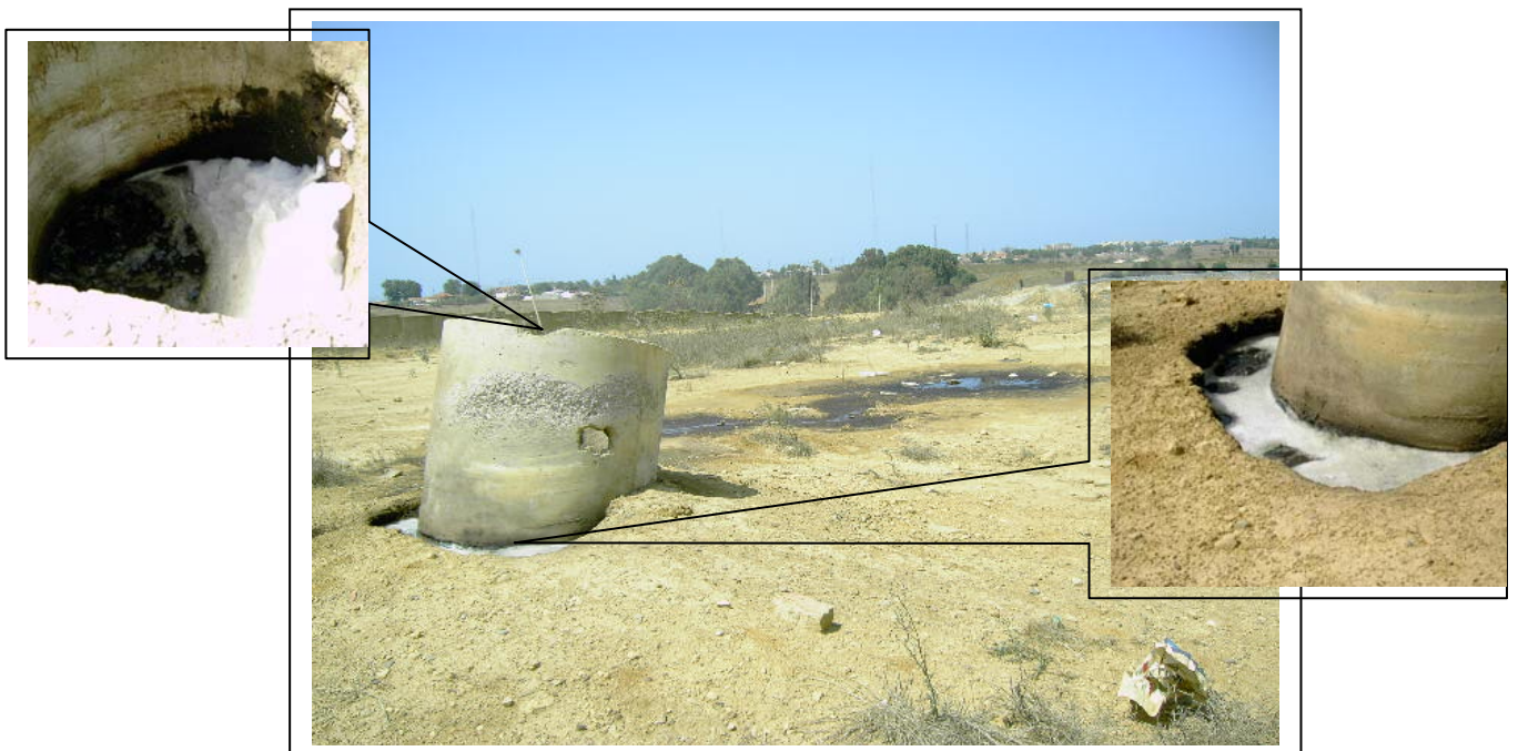
Figure V-12 : Refoulement de lixiviats vers l'extérieur au niveau du cheminé de récupération des Biogaz du Casier N° 1
