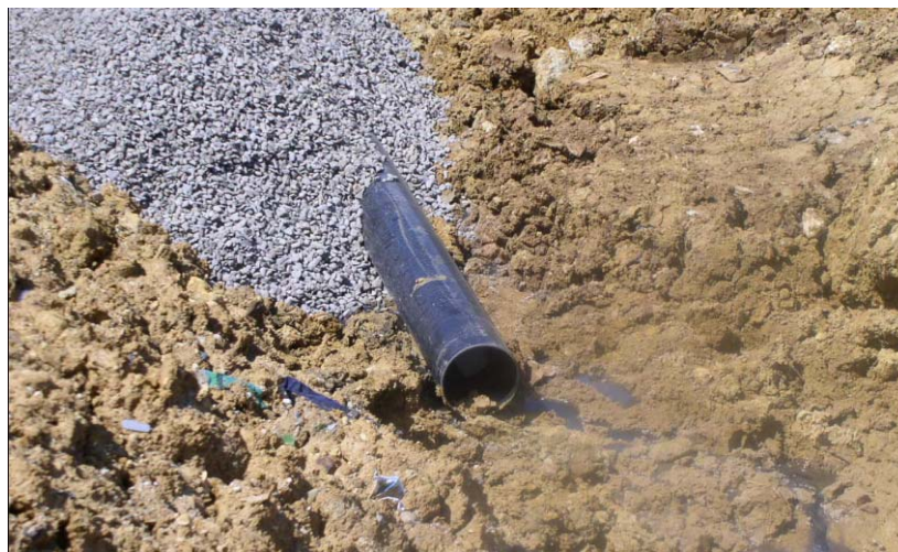
Figure 4 : conduite de drainage des lixiviats.
