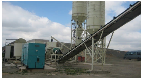
Centrale de malaxage de GC
