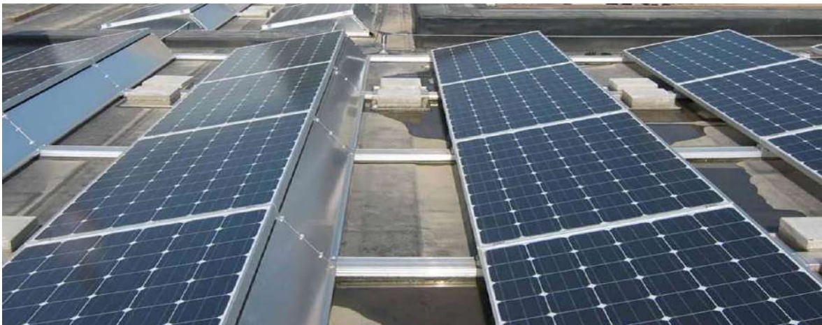
Figure I.3 : Exemple d'installation des panneaux photovoltaïques
