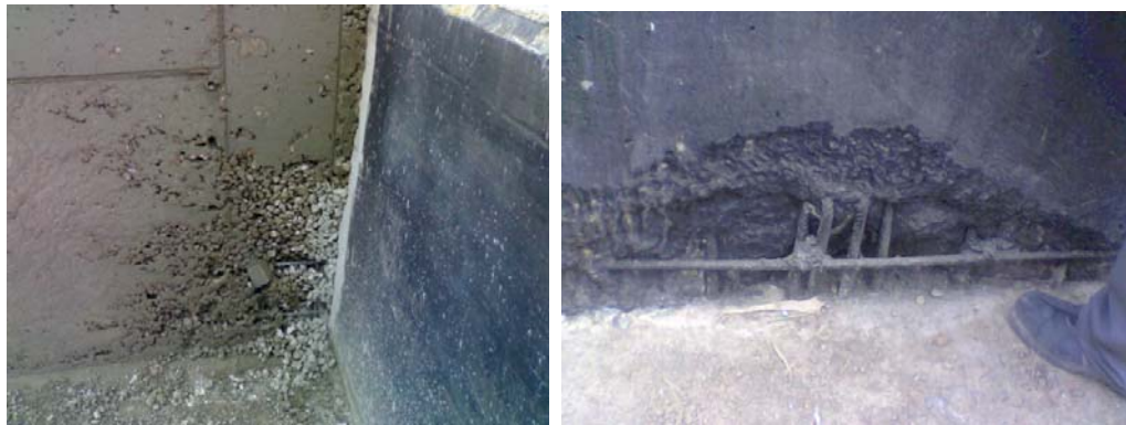
Fig I.3 Ségrégation due au mauvais de malaxage et coulage [15]
