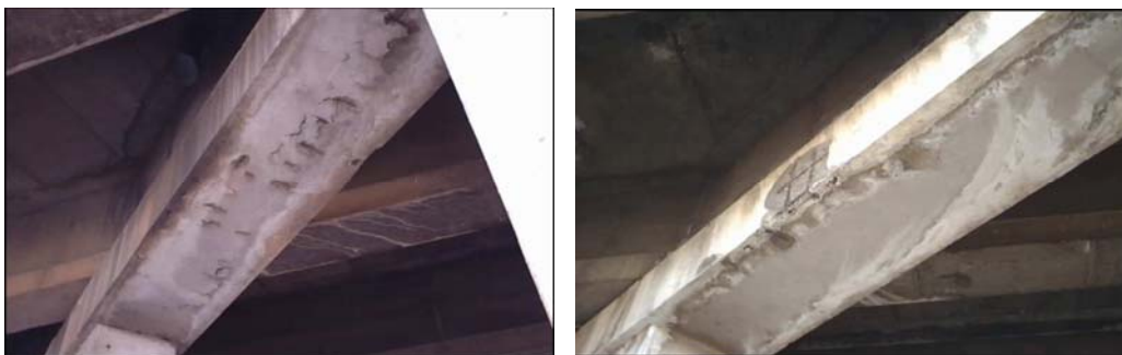
Fig I.7 Dégradation du pont Front de mer Oran [15].
