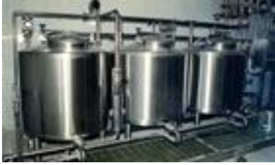
Stockage des solutions de nettoyage pour la station CIP
