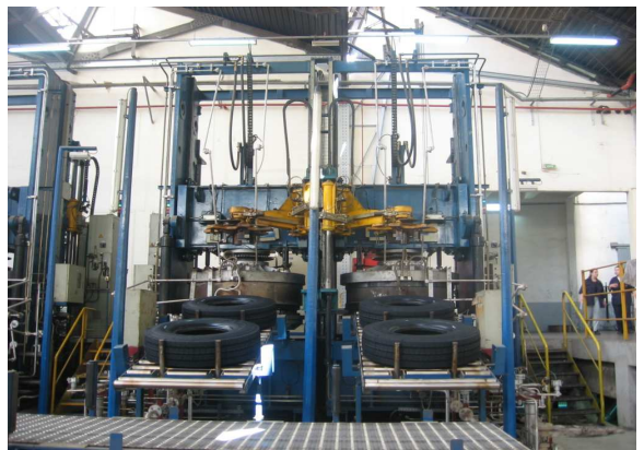
Figure 40 – Poste déchargement de 2 presses.
