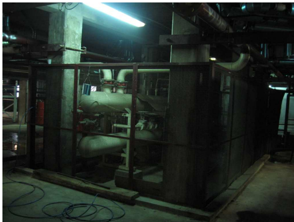
Figure 77 – Centrale du vide.
