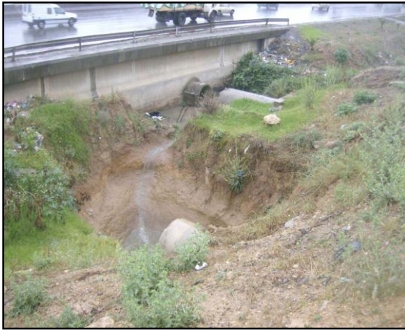
Photo IV.5: Tête amont du collecteur de l'oued Ouchaiah (2X DN 2000) au Nord de la rocade Sud
