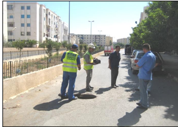
Photo V.1 : Regard d'accès-point de mesure M1_06
