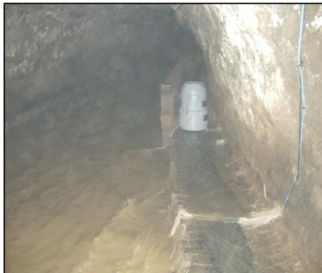
Photo IV.3: Préleveur installé en égout (Collecteur M'Kacel)
