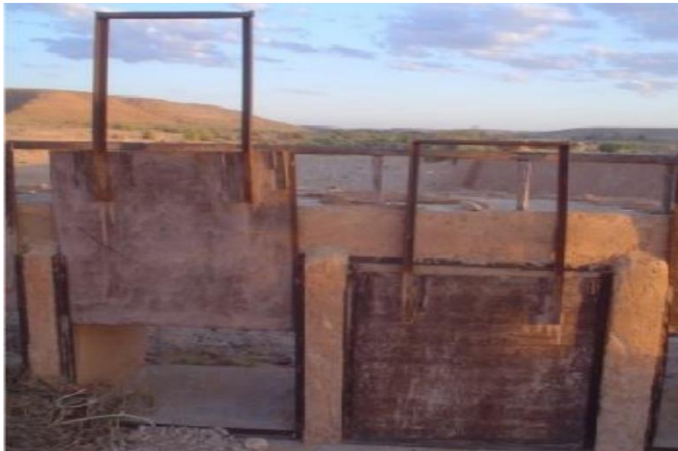
Figure III.4. Vannes métalliques de régularisation de débit (DJOUDI et RAFA, 2009).
