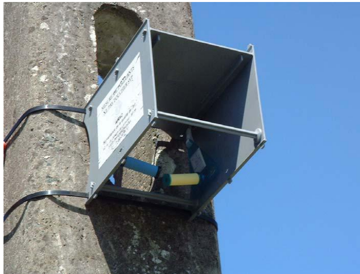
Photo 1 : Tubes à diffusion « Radiello » avec la boîte de protection installée sur site
