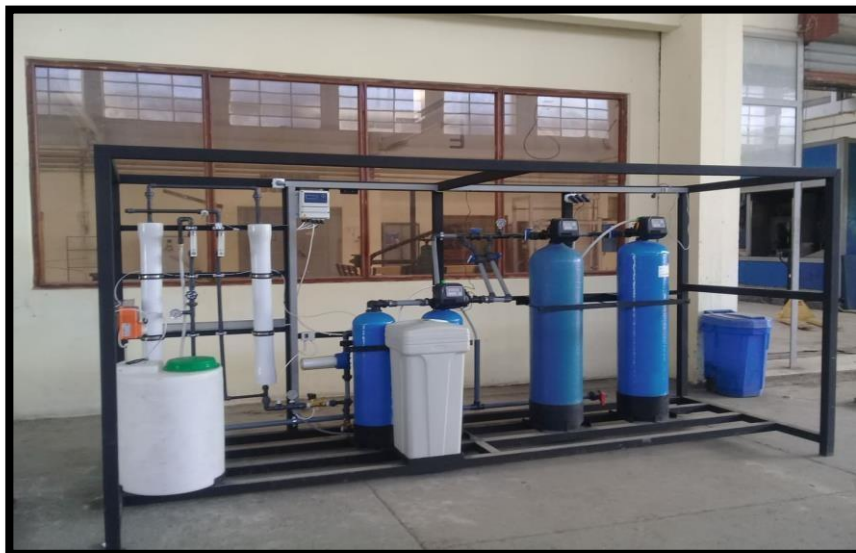
Figure 3-3: Unité pilote de traitement d'eau
