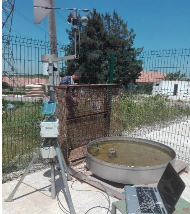
Figure 5.13: Station météo du barrage de Douera
