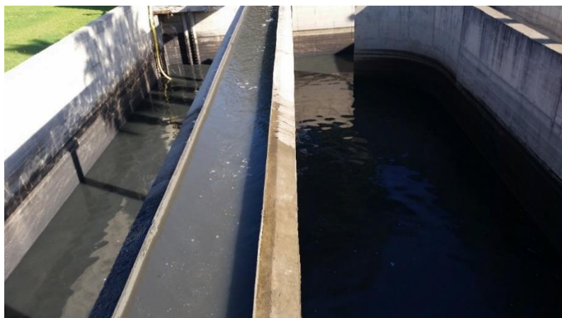
Figure 4-4 Arrivée d'eau et bassin d'orage de la STEP de Boumerdès.
