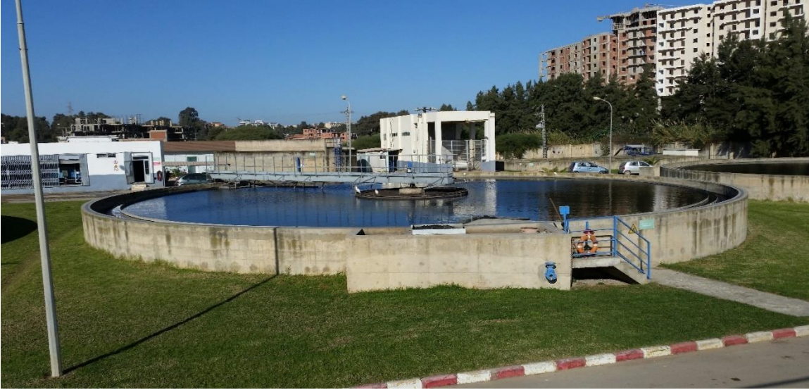
Figure 4-7: Clarificateur de la STEP de Boumerdès
