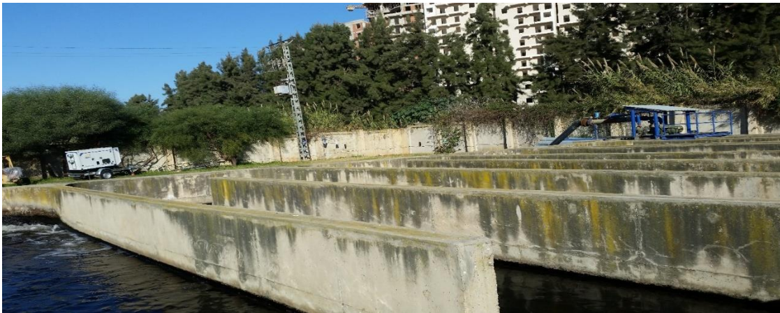
Figure 4-8 Bassin de chloration de la STEP de Boumerdès
