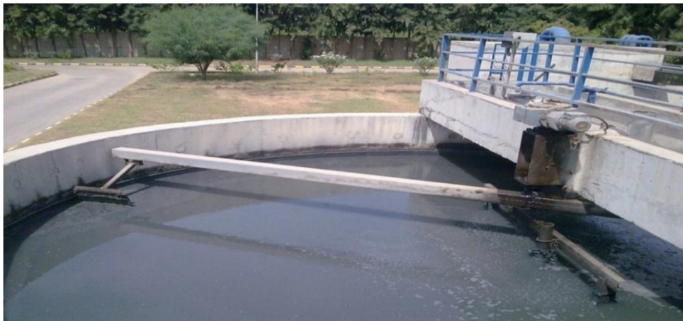
Figure III.4 :Désableur-dégrilleur de la STEP de Boumerdes
