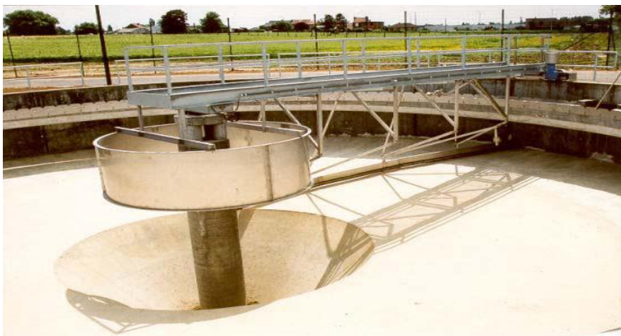
Figure II.7 – Décanteur primaire avec pont racleur à entraînement périphérique
