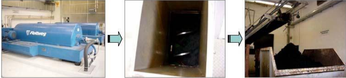
Figure II.11 – Déshydratation des boues par centrifuge
