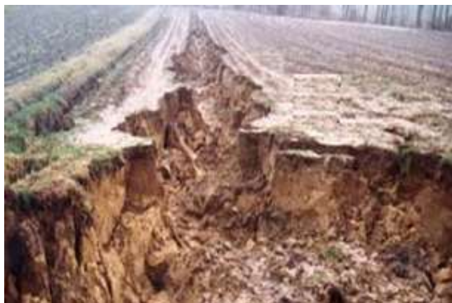
Figure 4: Erosion par ravinement
