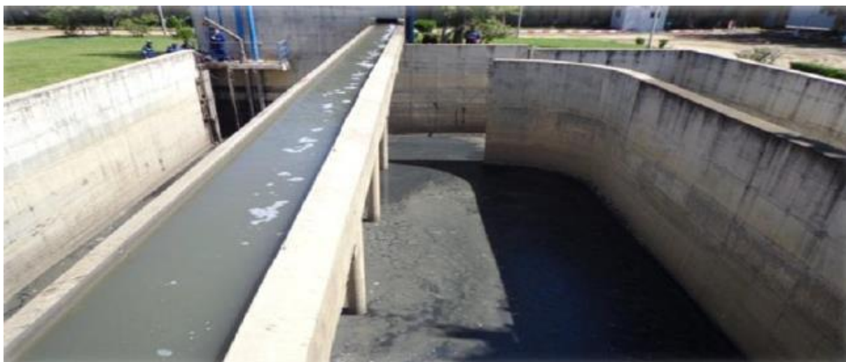
Figure IV. 4 : Bassin d'orage de la STEP de Boumerdes
