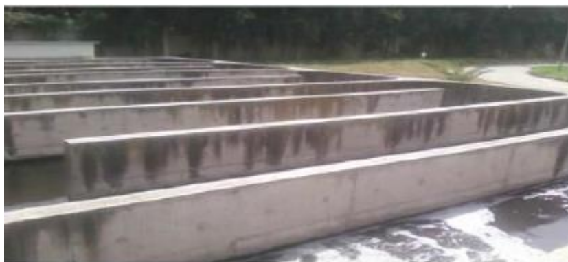
Figure IV. 9 : Bassin de chloration
