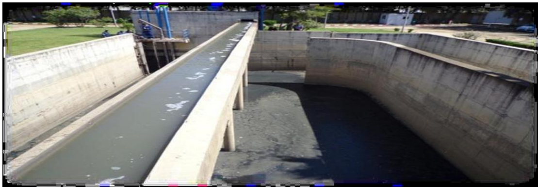
Figure IV. 5 Bassin d'orage de la STEP de BOUMERDES
