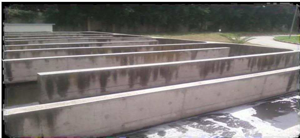
Figure IV. 10 Bassin de chloration
