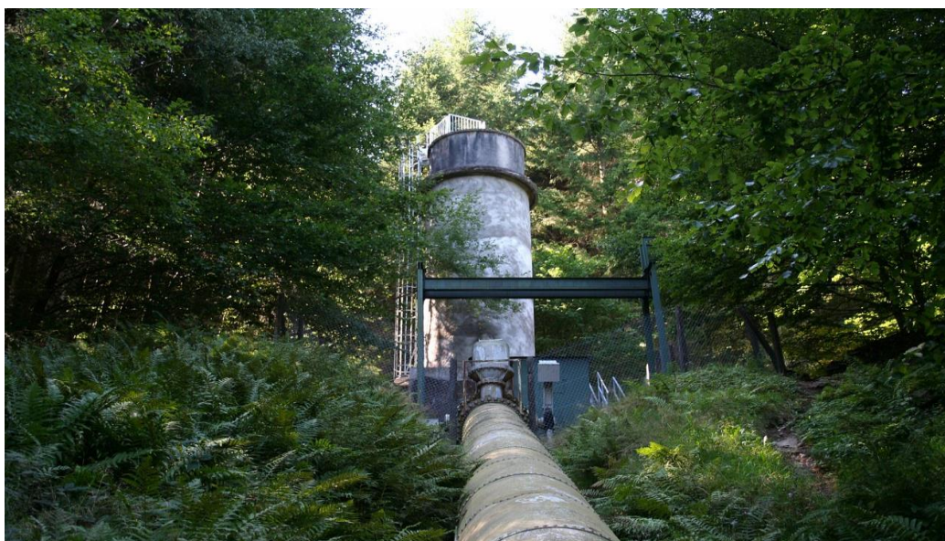
Figure VI. 5: Cheminée d'équilibre d'un circuit d'irrigation.
