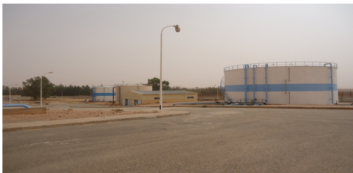
Figure III. 3 : station de pompage de la zone centre SP106
