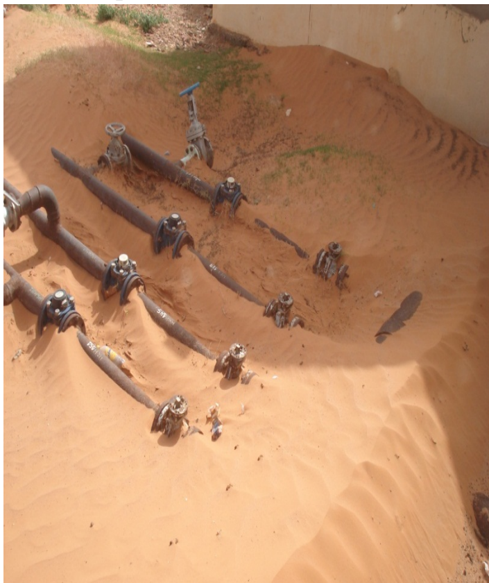
Figure IV. 23: les compteurs des conduites de refoulement de la station SP127
