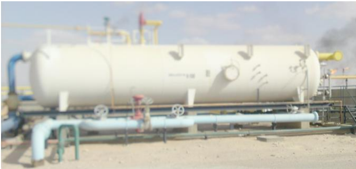
Photo I. 2 : dégazeur de l'unité de déshuilage du CIS
