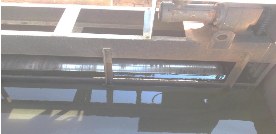
Photo I. 4 : Skimmer à tambour oléophile du bassin API de l'unité de déshuilage du CIS
