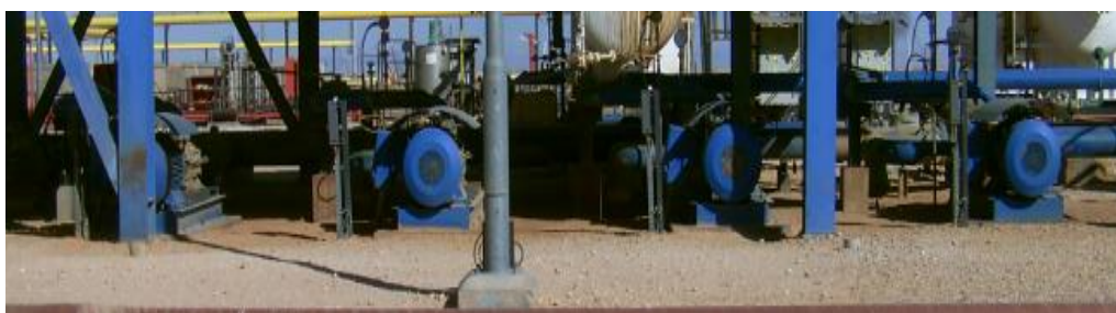
Photo 9 : Pompe d'expédition d'eau traitée de la station de déshuilage du CIS
