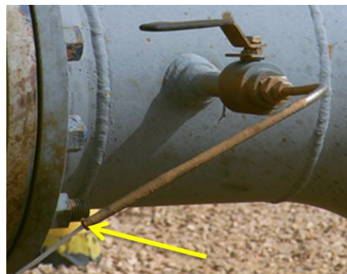
Photo V. 2 : purge ouverte à fort débit
