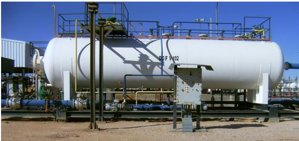
Photo I. 8 : Ballon DGF de l'unité de déshuilage du CIS
