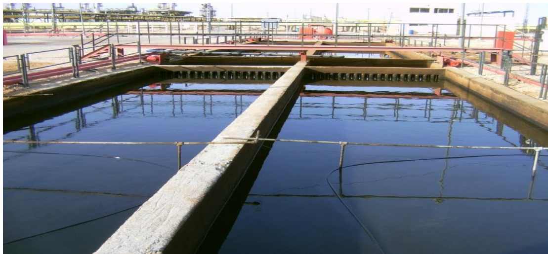
Photo III. 3 : les deux compartiments du bassin API en fonctionnement
