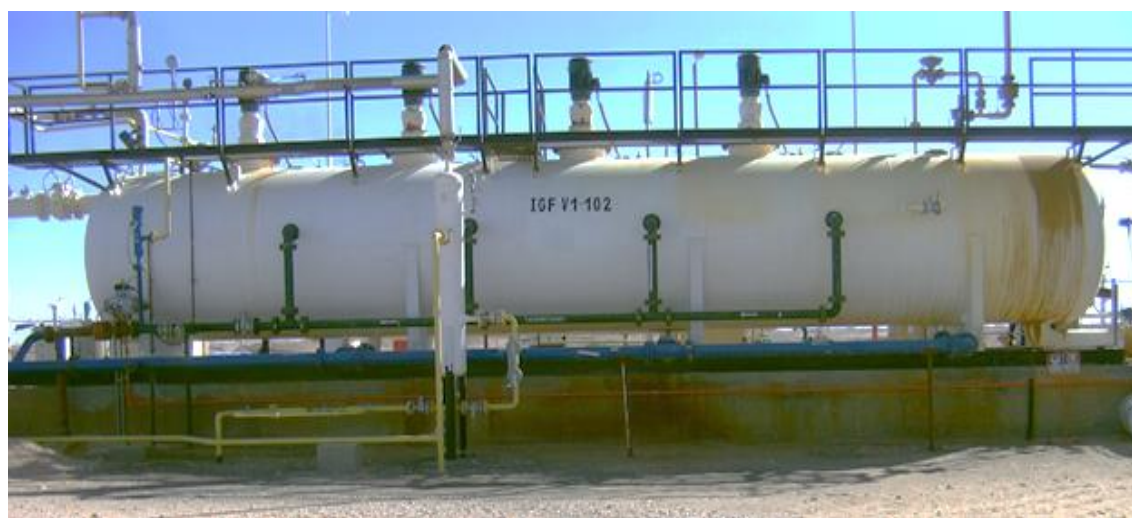
Photo I. 7 : ballon IGF de l'unité de déshuilage du CIS
