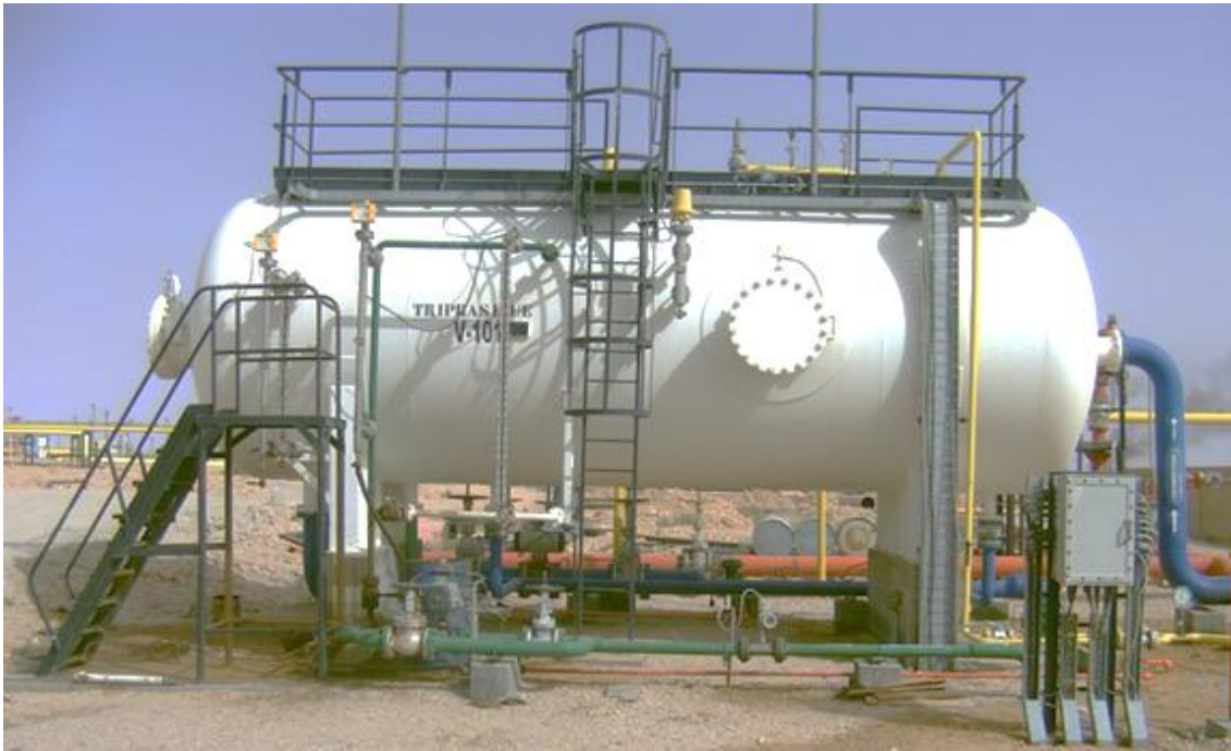
Photo I. 1 : séparateur tri-phasique de l'unité de déshuilage du CIS
