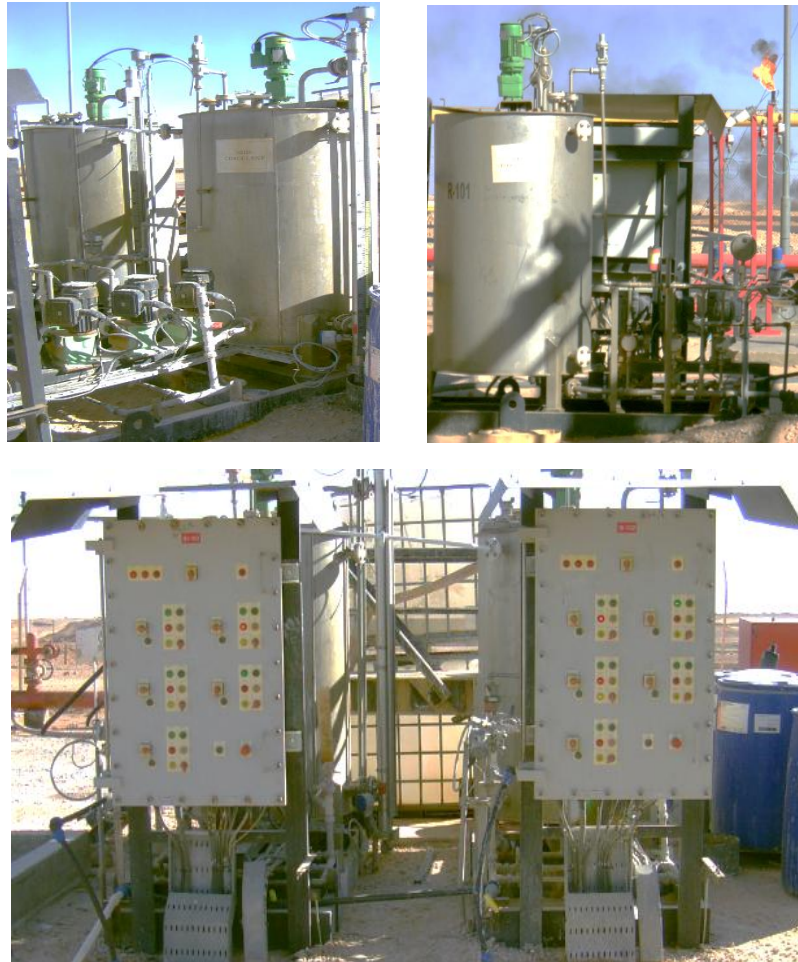
Photo I. 9 : instruments et skids d'injection coagulant/floculant
