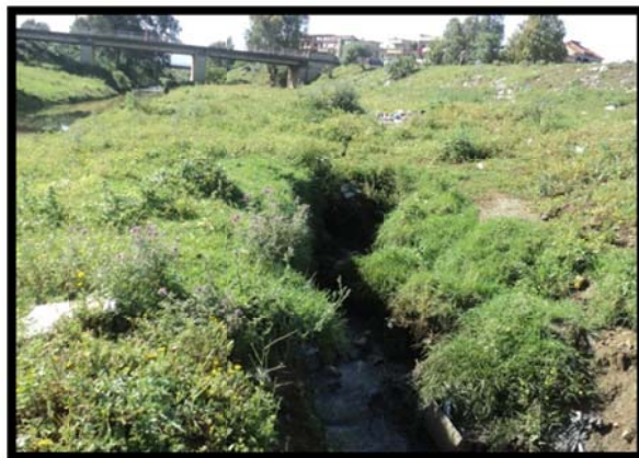
Photo IV.5 : rejets des eaux pluviales
