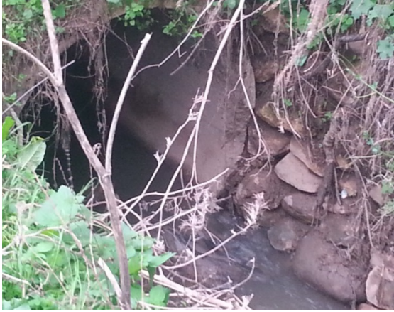
Photo 1 : rejet d'eaux usées directement dans le cours d'eau
