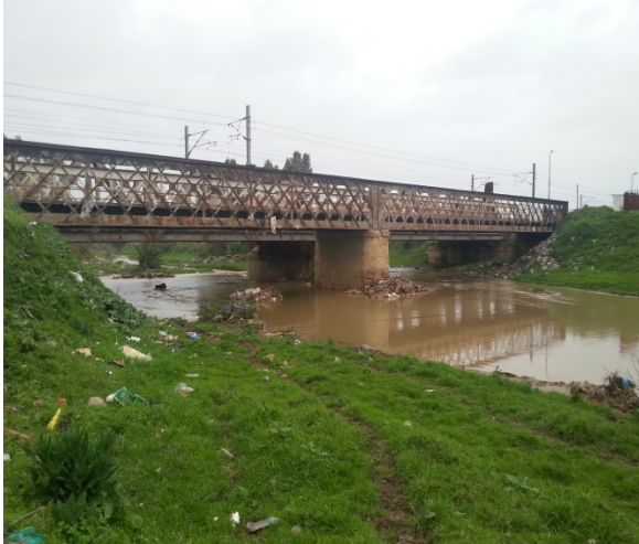
Photo 5 : des embâcles qui s'accumulent sur les piles de pont et au plein milieu du cours d'eau
