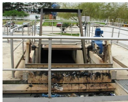
Photo IV.2 : dégrilleur, tapis roulant
