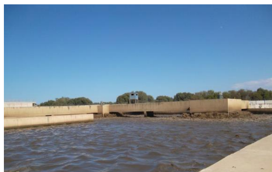
Photo IV.9 : bassin d'aération zone
