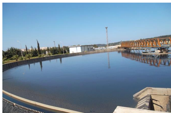
Photo IV.6 : bassin de décantation primaire
