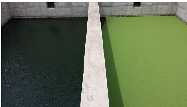
Photo IV.15 : filtration au sable avec la mise en eau
