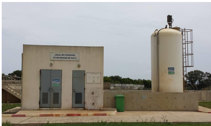
Photo IV.12 : l'équipement d'injection chlorure ferrique
