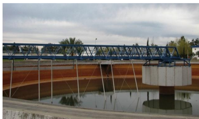
Photo IV.5 : bassin de décantation primaire
