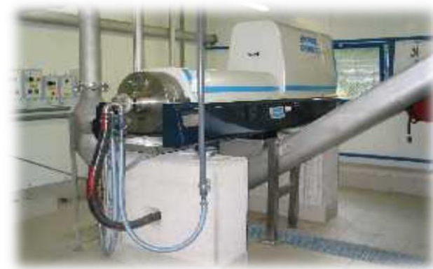
Figure II.13 : Déshydratation des boues
