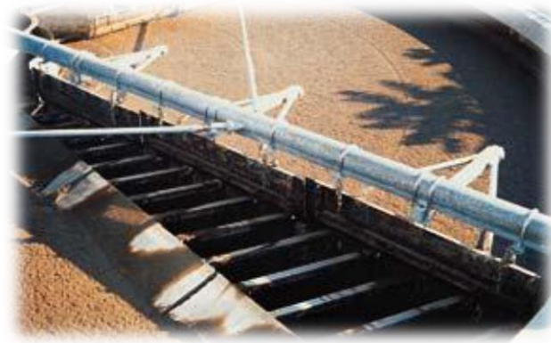
Figure II.12 : Epaissement des boues
