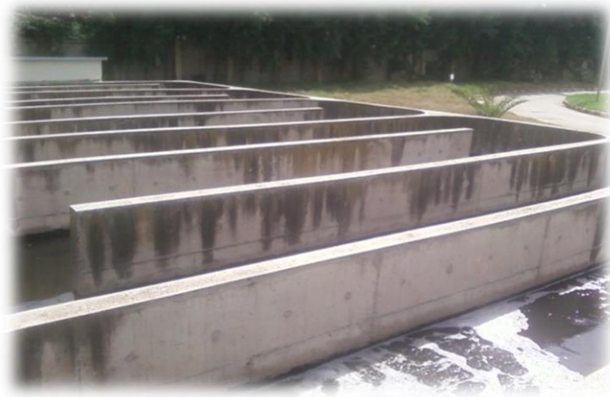
Figure IV.10 : Bassin de chloration.
