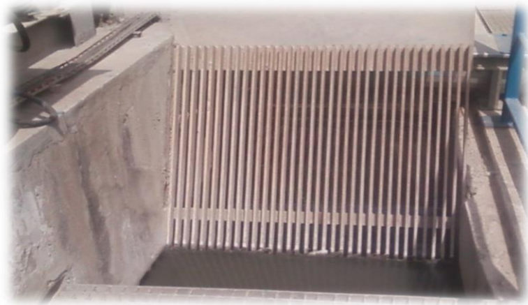
Figure IV.6 : Dégrilleur du type à champ courbe.
