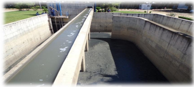
Figure IV.5 : Bassin d'orage de la STEP de BOUMERDES
