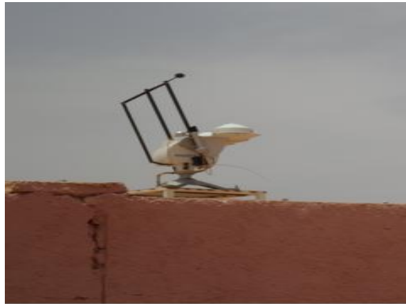
Figure IV.2. Pyranomètre de la station météorologique de l'unité de recherche appliquée aux énergies renouvelables de Ghardaïa (URAER)
