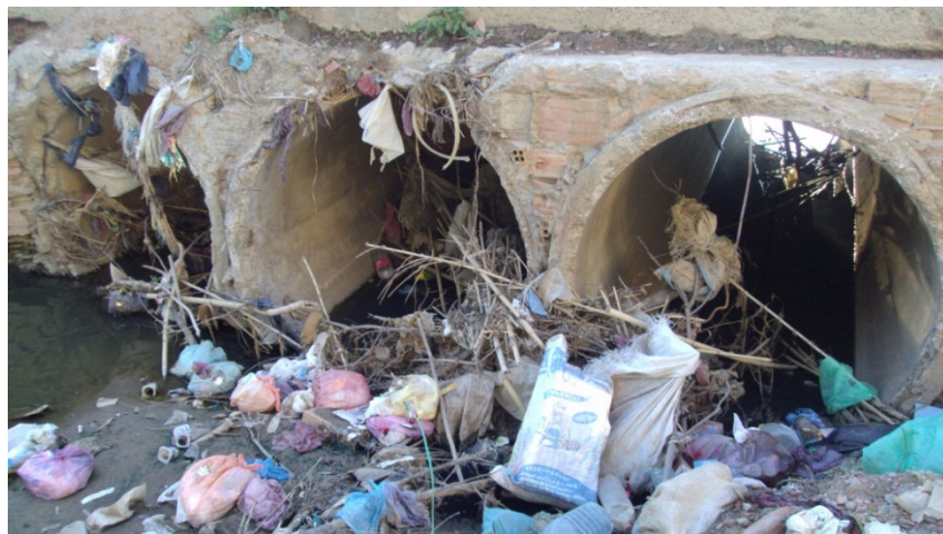
Figure IV-3 : Déchets solides qui occupent le passage busé
