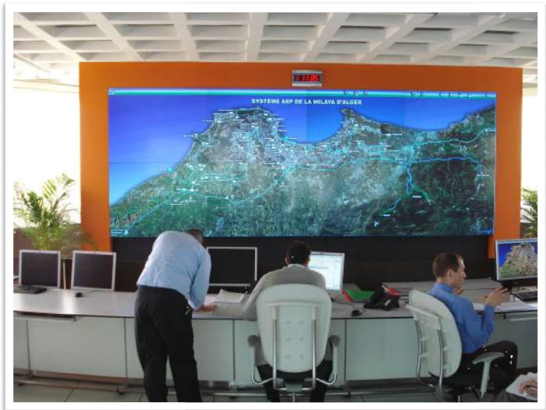
Figure I-2: Centre de télé-contrôle
