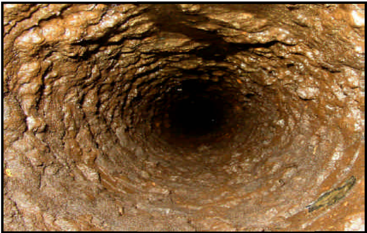
Figure II-1 : Etat d'une canalisation avant nettoyage (Source AXEO)
