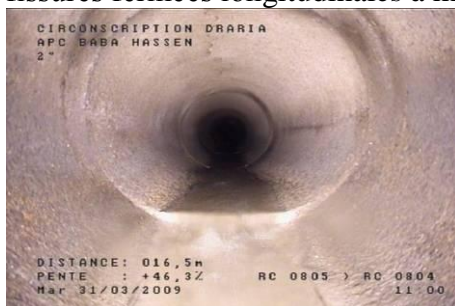
Figure 10 : Photo de fissures longitudinales
