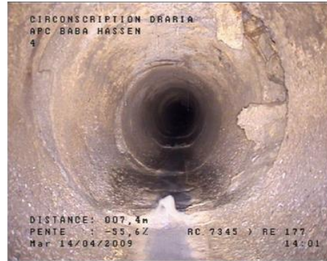
(BAF.F) Dégradation de surface - Armature visible de 01h à 02h
