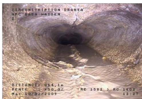
(BAC.B) Effondrement partiel
