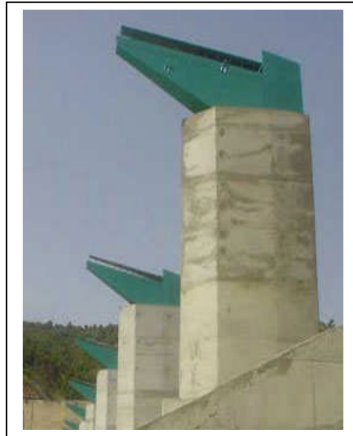
Figure III.15 : hausse fusible de barrage Benni Amrane
