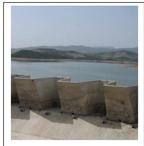
Figure III.17 : hausses fusibles de barrages Ghrib
