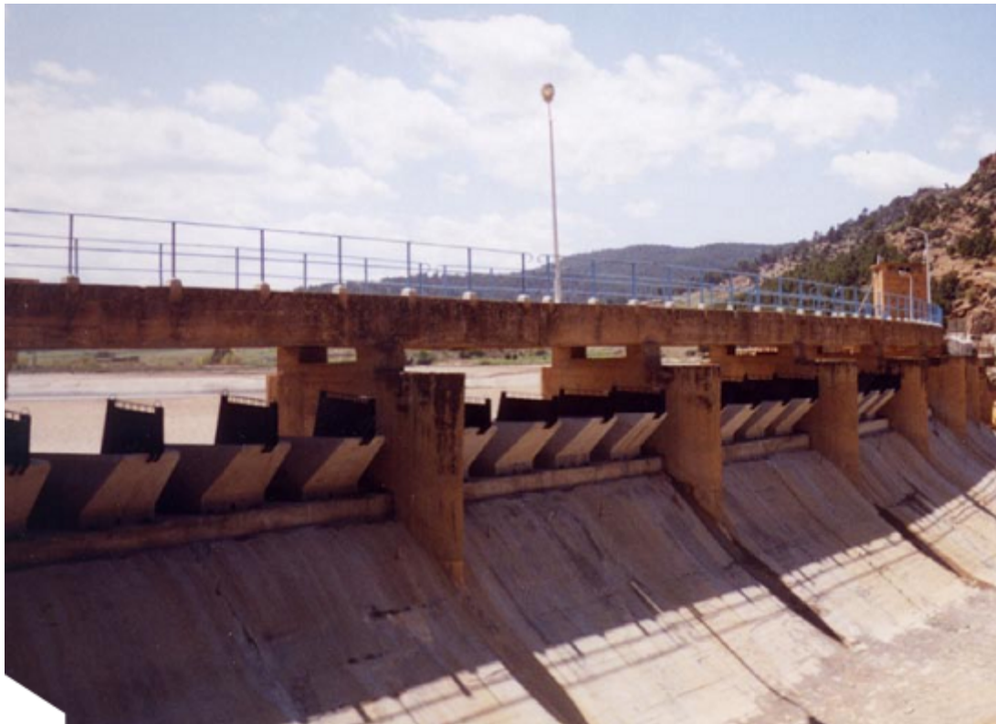
Figure VI.7 : Le barrage Fom El Gueiss équipé par les hausses fusibles
