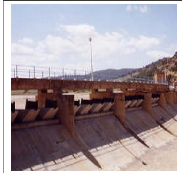
Figure III.16 : Hausses fusibles de Barrage Foug El Gueiss
