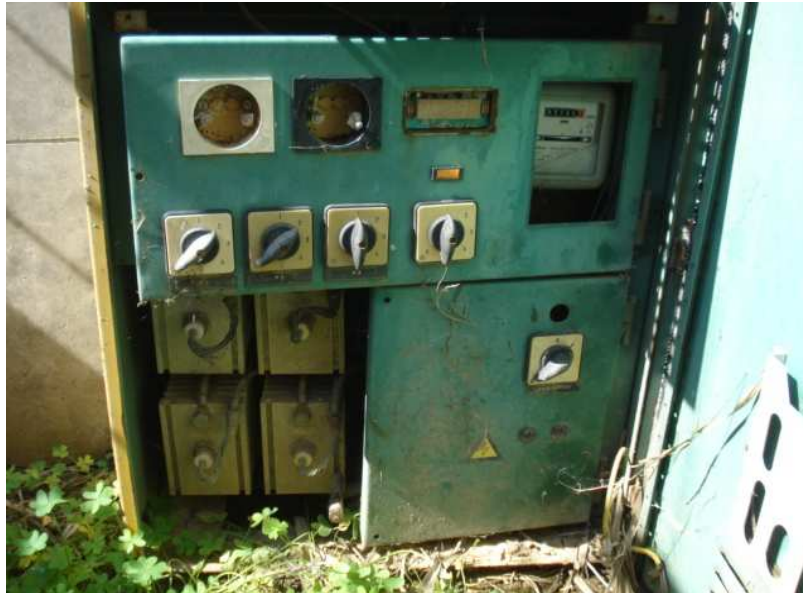
Photo 05: Etat de transfo-redresseur.
