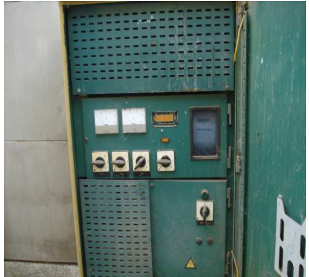
Photo 01: Etat de transfo-redresseur.
