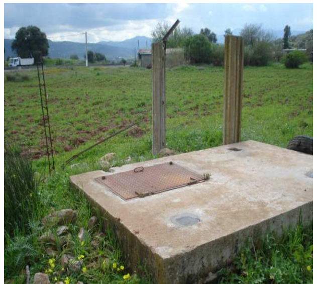
Photo 02 : état du poste N° 2.
