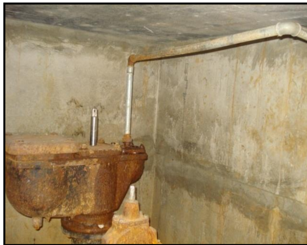
Figure V-5 : Un seul piquage illicite sur une soupape située au bord du village Mezarea Commune de Boudouaou
