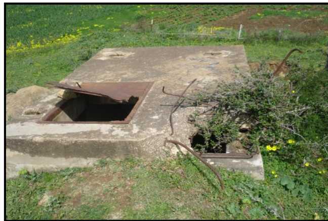
Figure V-3: Regard détérioré, non étanche situé à Boudouaou
