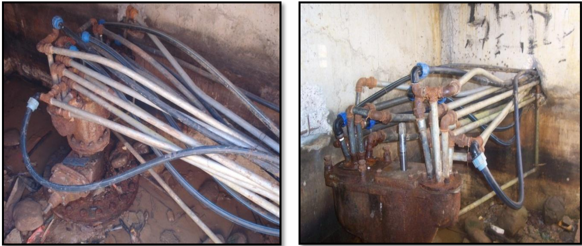
Figure V-6: nombreux tuyaux branchés sur une soupape à Boudouaou
