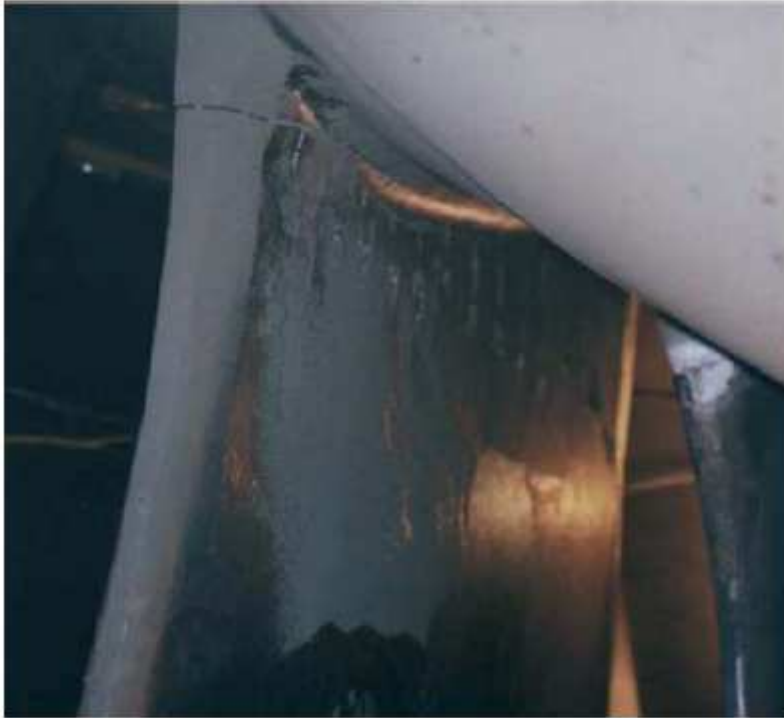
Figure 3.7 : Fissure à la jonction aube plafond
