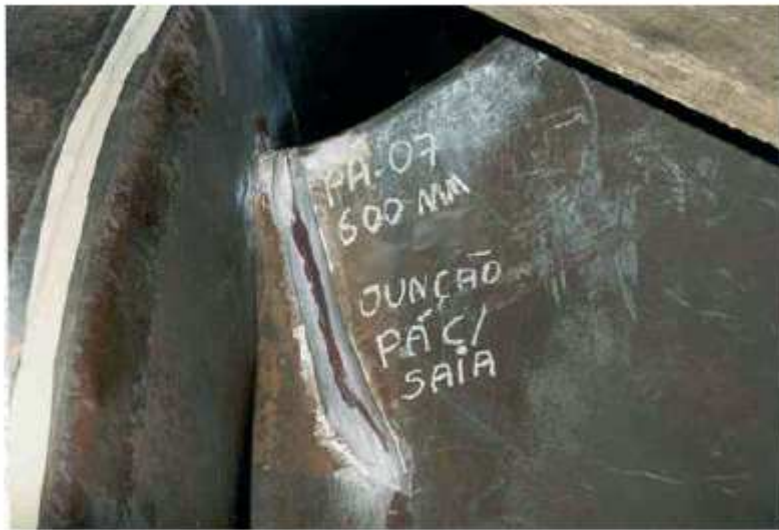
Figure 3.6 : Fissure à la jonction aube ceinture
