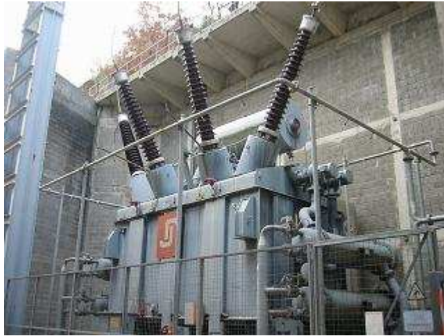
fig 4.12 un transformateur (Pouget Suréquipement)
