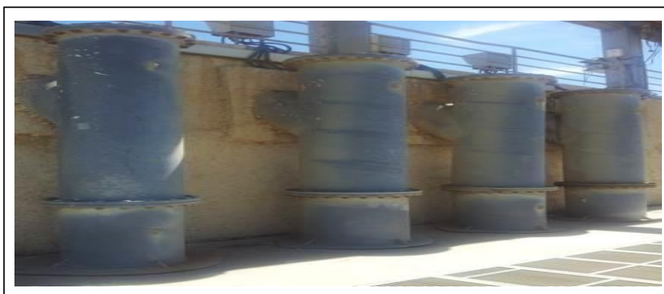
Annexe 12 : Station de relevage
