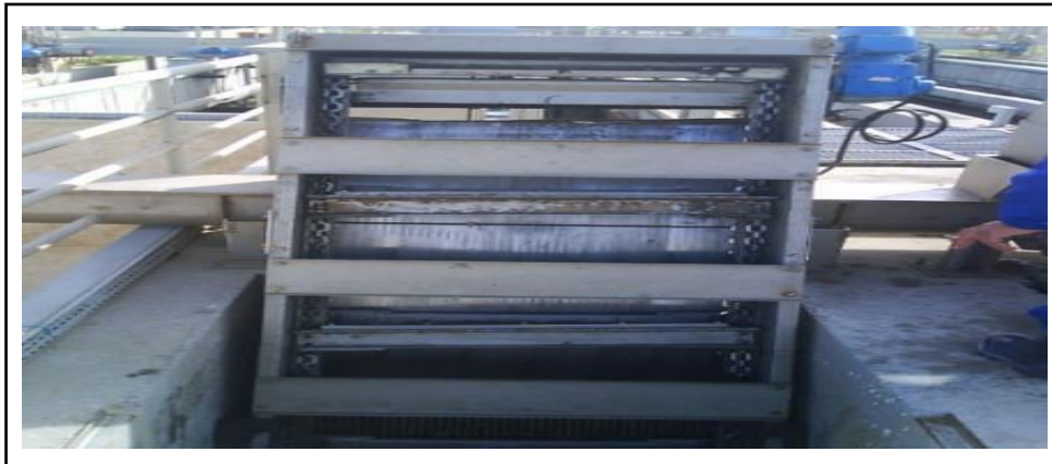
Annexe 13 : Dégrilleur fin
