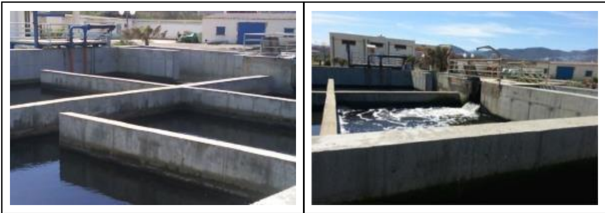
Annexe 18 : Bassins de désinfection
