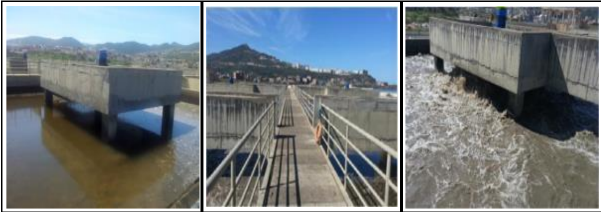
Annexe 16 : Bassin d'aération
