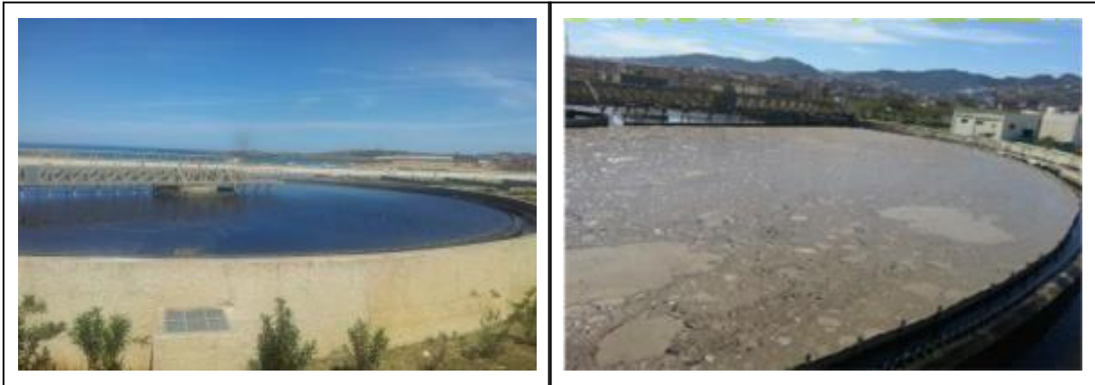
Annexe 17 : Décanteur secondaire
