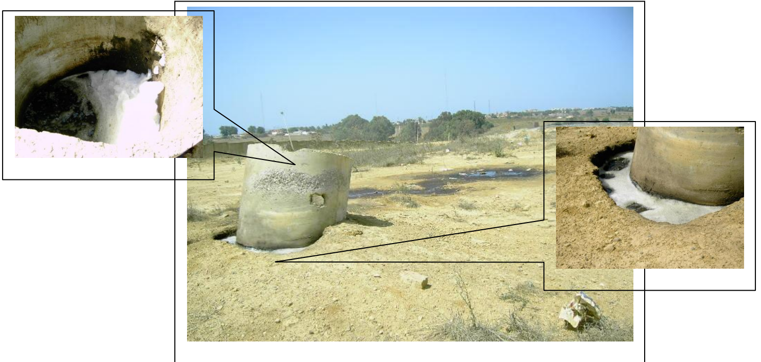
Figure V.16 Refoulement de lixiviats vers l'extérieur au niveau du cheminé de récupération des Biogaz du Casier N° 1, Ouled Fayet
