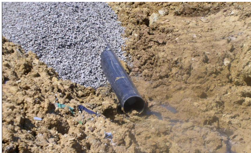
Figure V.11 : conduite de drainage des lixiviats.
