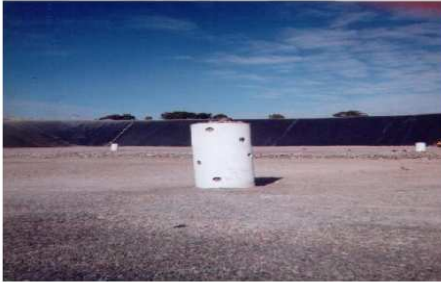
Figure II.10 : les buses d'évacuation de Biogaz
