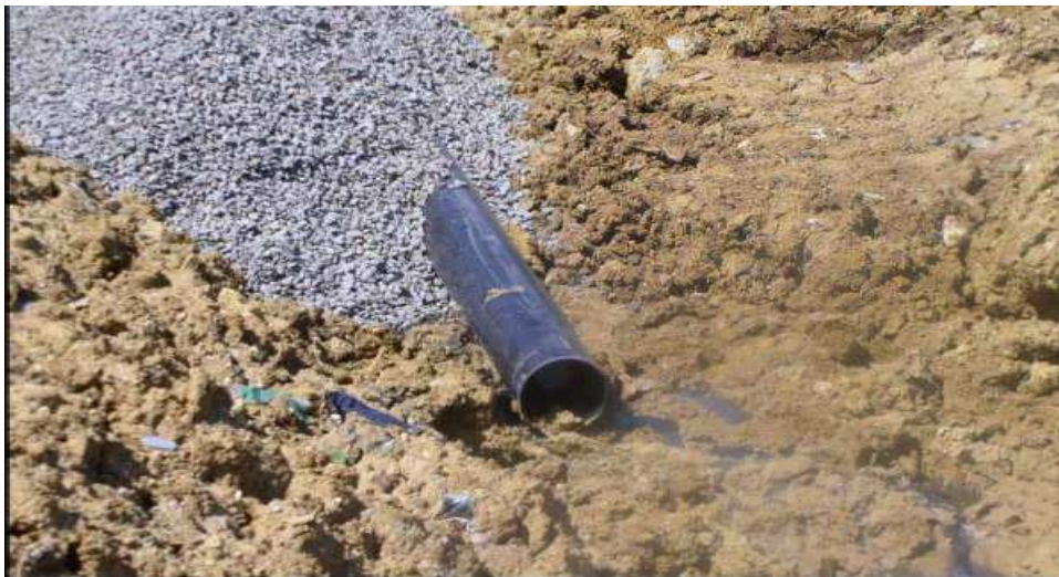
Figure II.9 : Conduite de drainage des lixiviats.
