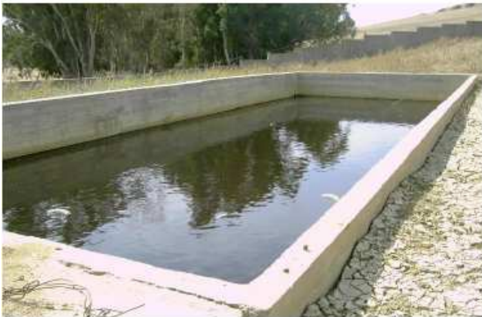
Figure II.11 : Le bassin de décantation de lixiviats.
