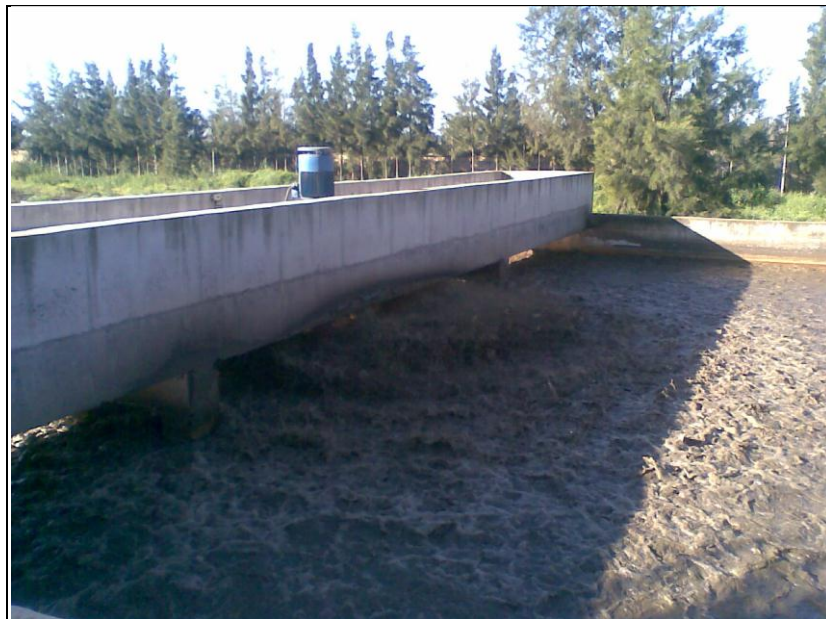
Figure 11 - Bassin d'aération de la station d'épuration de Kolea.
