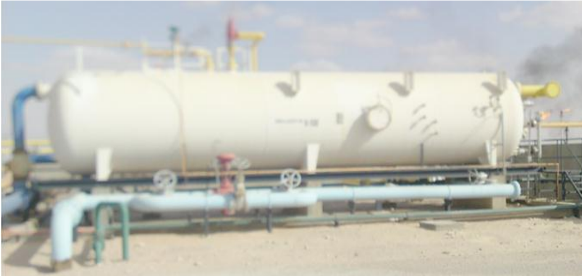
Photo I.2 : dégazeur de l'unité de déshuilage du CIS
