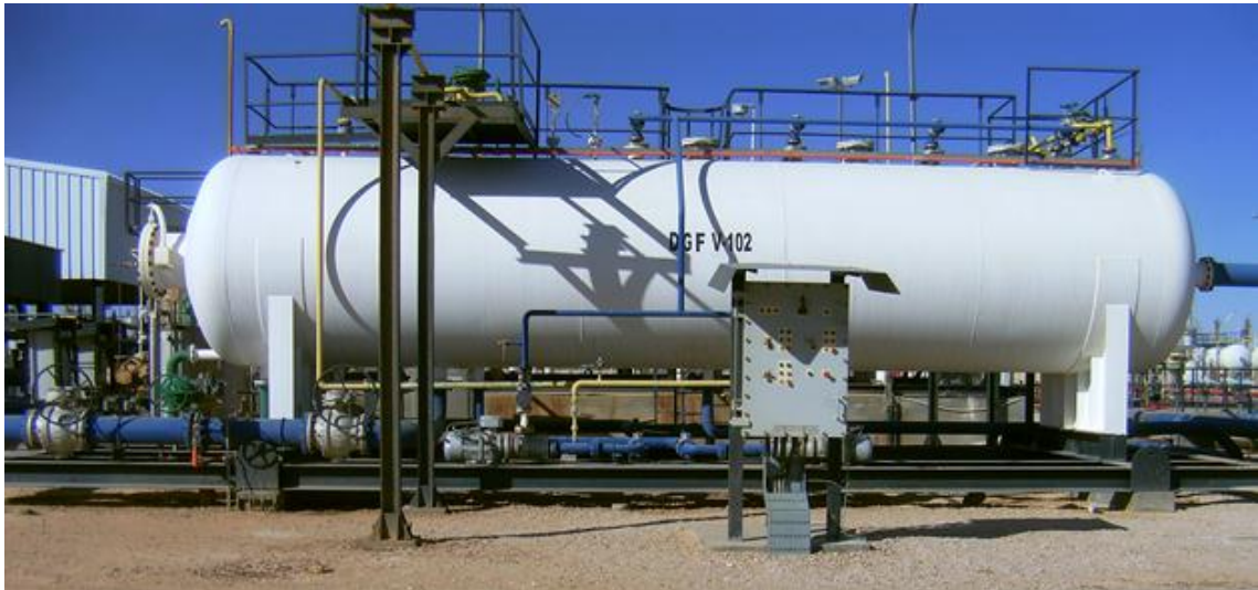
Photo I. 5 : Ballon DGF de l'unité de déshuilage du CIS
