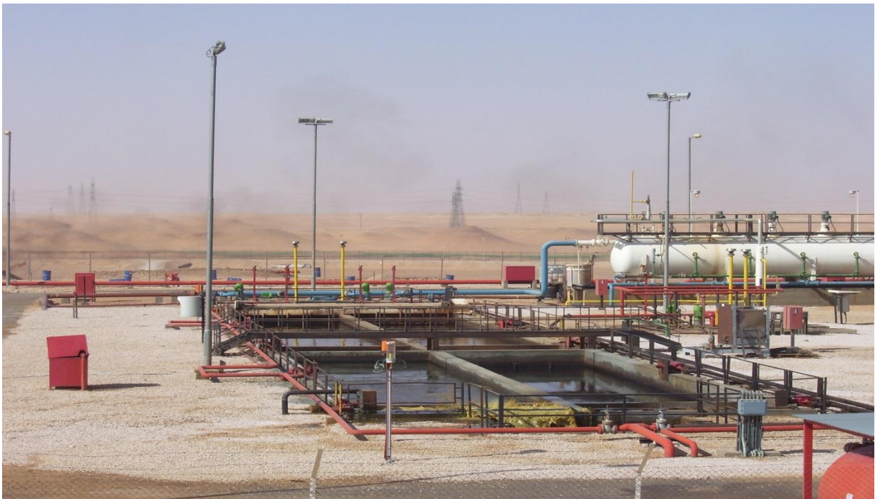
Photo I. 3 : bassin API 2 de l'unité de déshuilage du CIS
