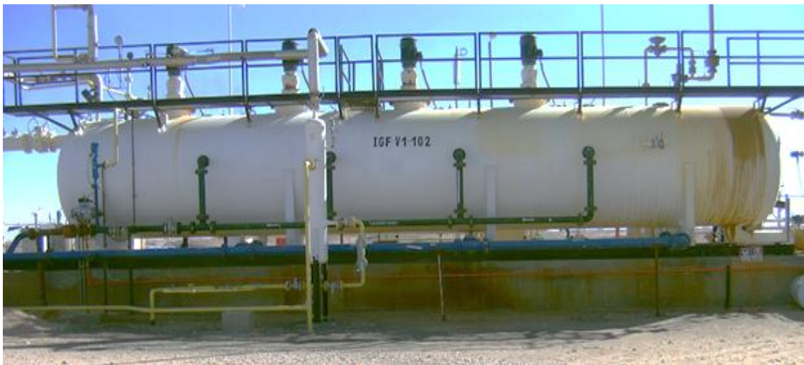
Photo I. 4 : ballon IGF de l'unité de déshuilage du CIS
