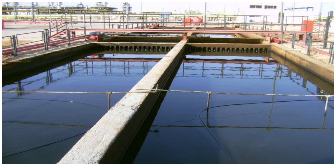
Photo II.4 : les deux compartiments du bassin API en fonctionnement
