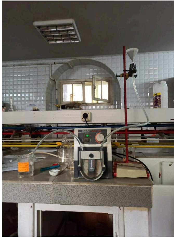
FIG. 3.12 : Pompe de filtration.
