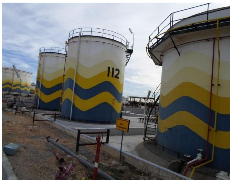
Figure 3-7 : Cuvette de rétention [EDD,2014]
