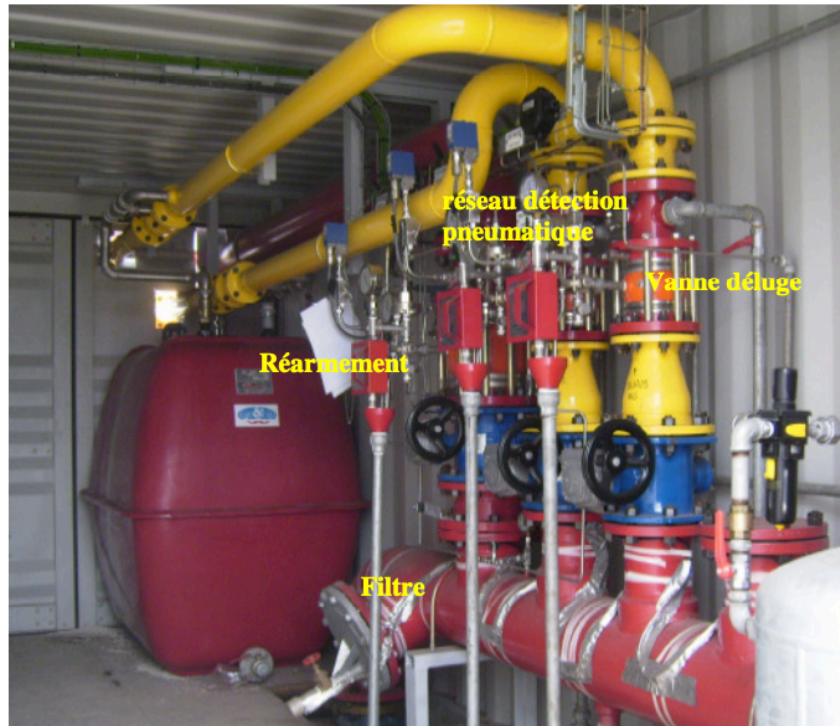
Figure 2-18 : : 3 vannes déluge avec déclenchement électropneumatique et réarmement local
