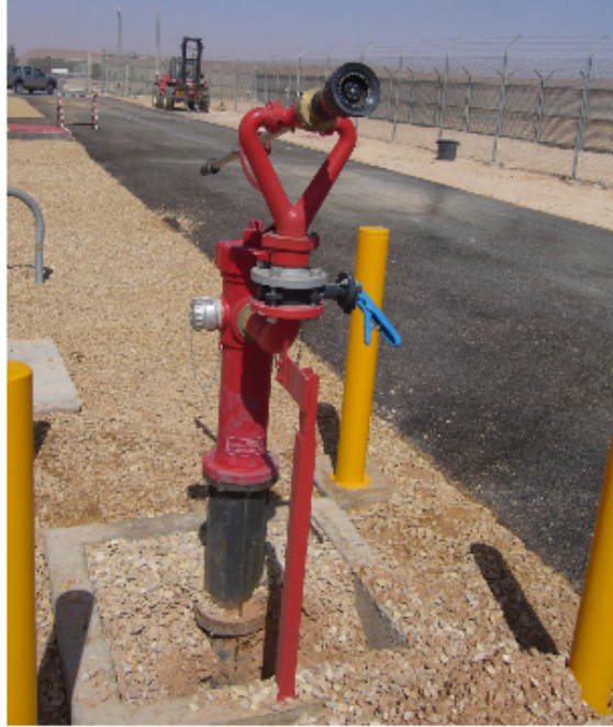
Figure 2-1 : Lance monitor connectée sur le réseau maillé enterré [3]
