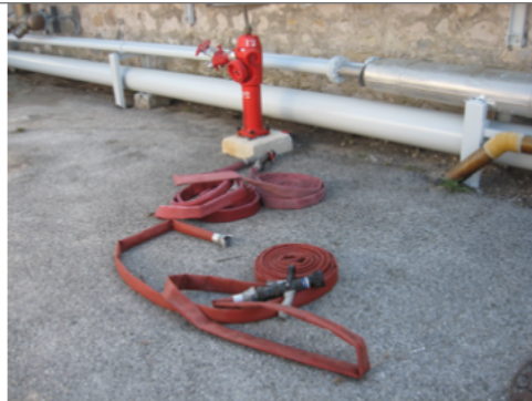
Figure 2-2 : Poteaux incendie, avec son établissement, et lance incendie [3]
